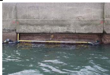
防波堤本体工の鉄筋露出状況 (霧多布港北防波堤)
