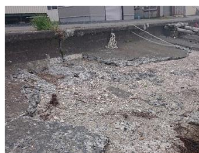
水叩きコンクリートの老朽化状況（稚内港海岸）
