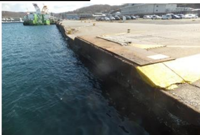
フェリー岸壁老朽化状況 (江差港)
