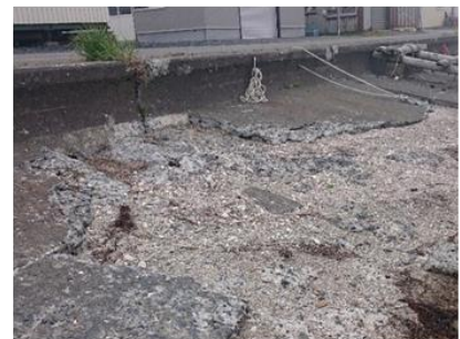
水叩きコンクリートの老朽化状況（稚内港海岸）
