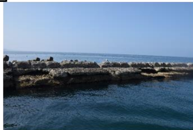
防波堤上部工のコンクリート劣化状況 (森港西防波堤)
