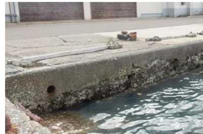
上部工のコンクリート劣化状況 (岩内港物揚場)
