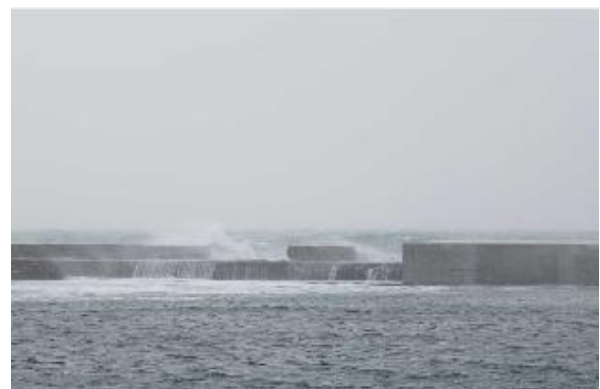
老朽化した防波堤(北外)の越波状況(室蘭港)
