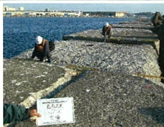
防波堤上部工の欠損状況 (釧路港東港区西防波堤)
