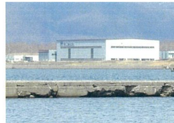
防波堤の老朽化状況 (岩内港防波堤(船入瀬))
