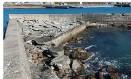
本体工のコンクリート劣化状況 (えりも港北防波堤)
