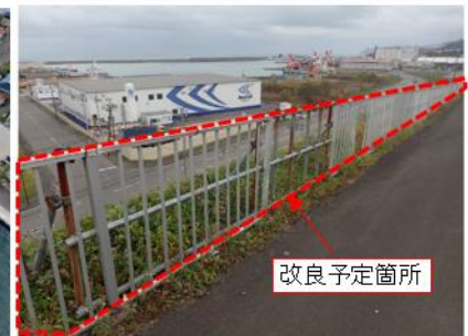
臨港道路の安全な通行確保のための 転落防止柵の整備 （十勝港）
